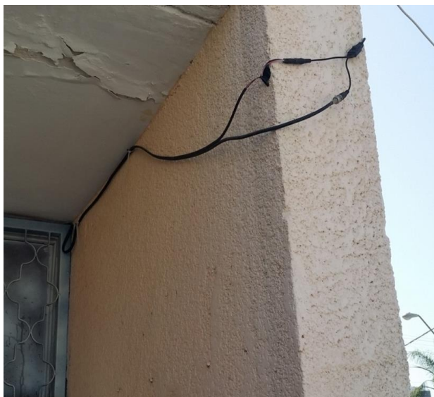
גן - כבל חשמל בכניסה שאינו מקובע
